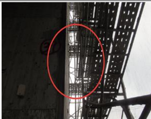
施工架與建築物間隙大於 20 公分未設置安全網
