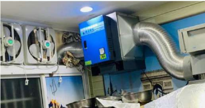
餐廳設置油煙防制設備
