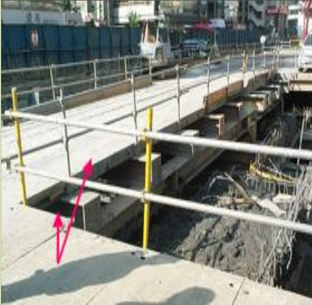
護欄缺腳踏板
