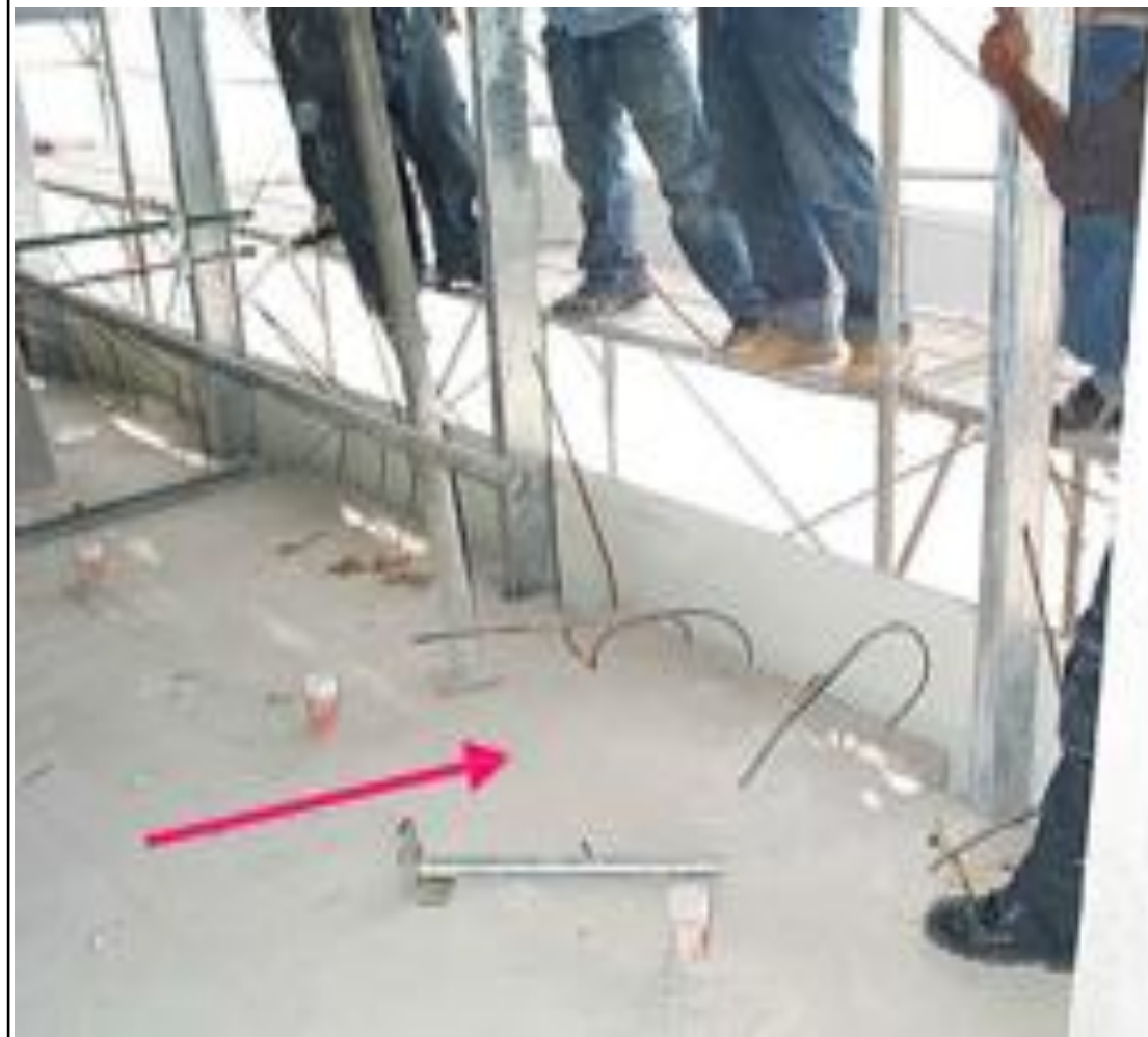
阻礙鋼筋 未處理。
