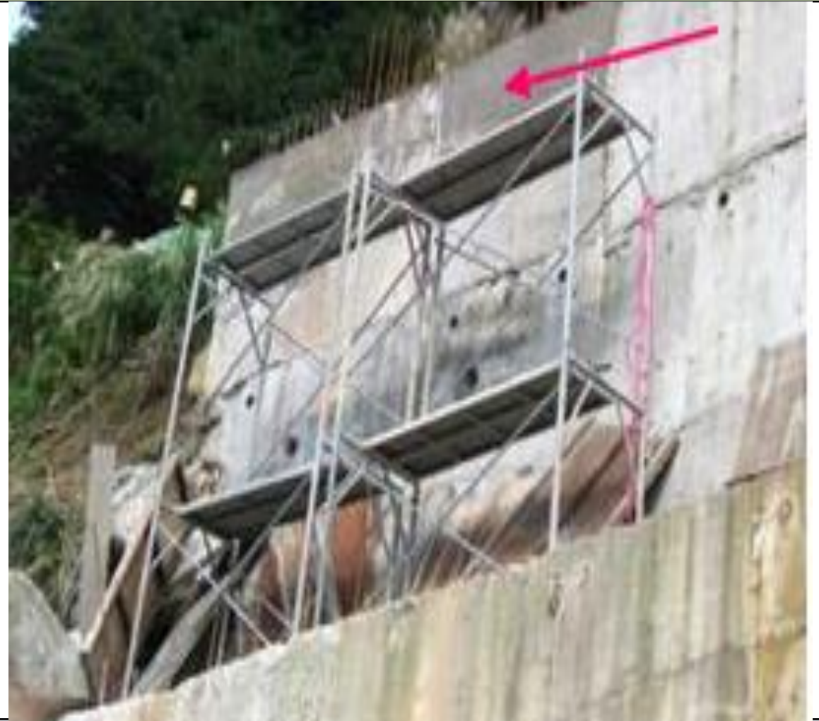
施工架缺護欄
