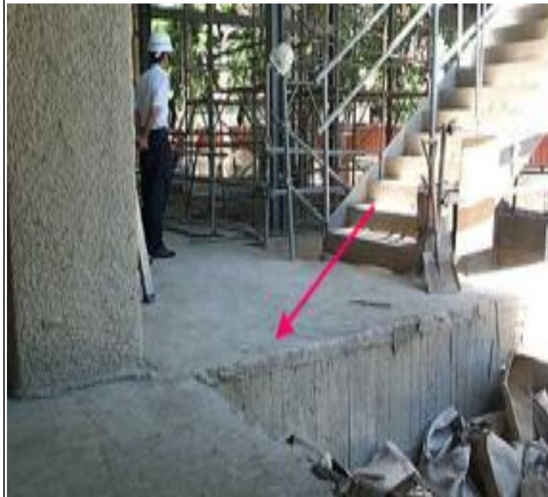
通道未設護欄
