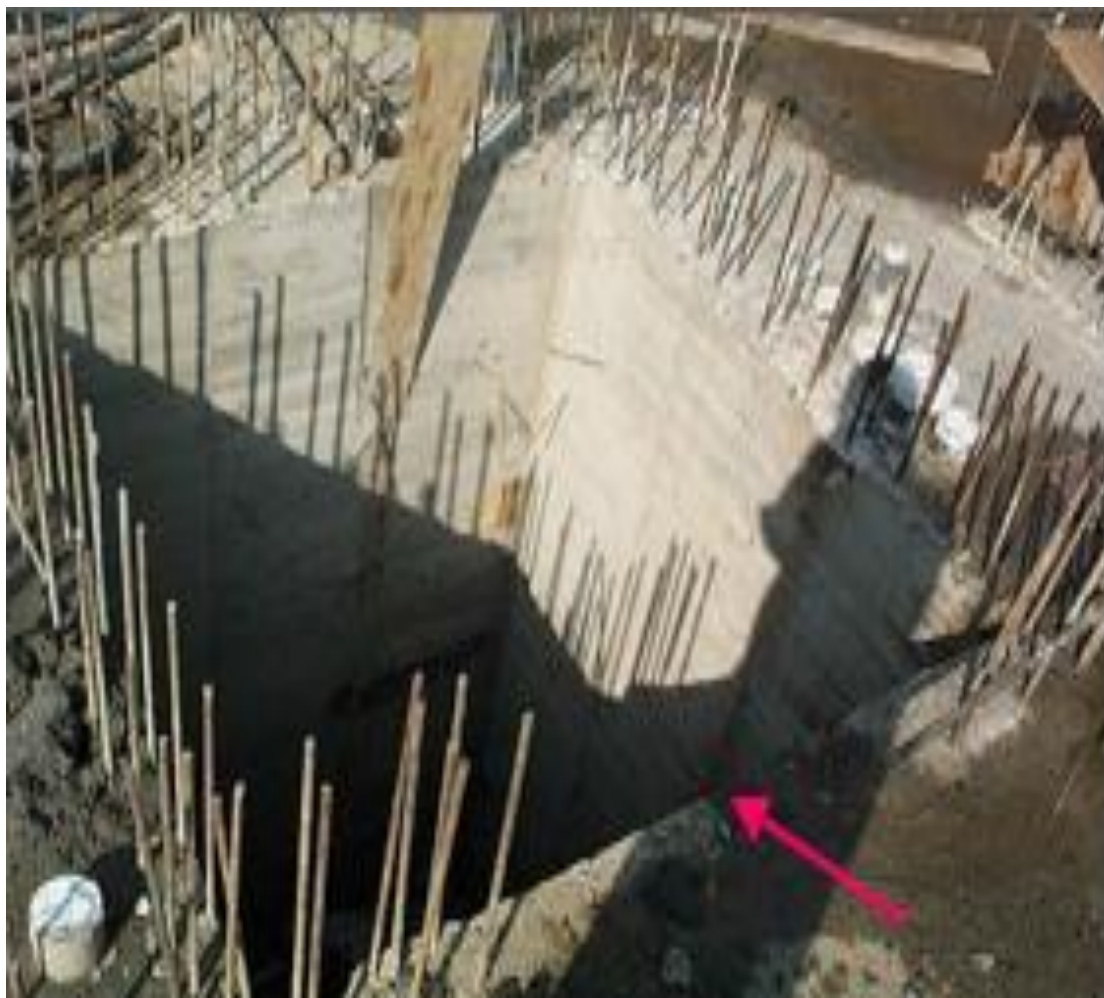
施工區警 示不足
