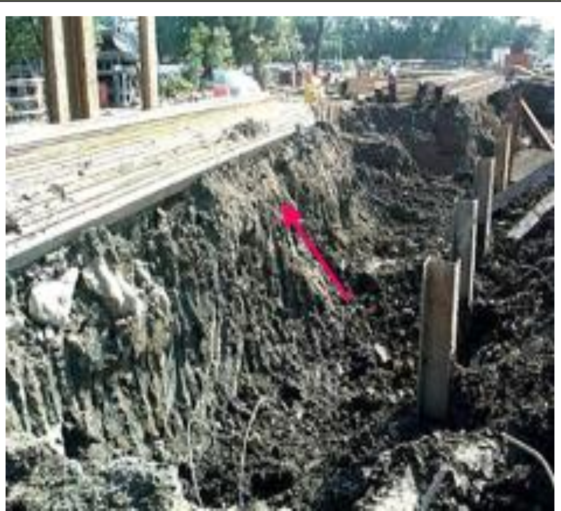
邊坡超過2公尺無防護措施及警語
