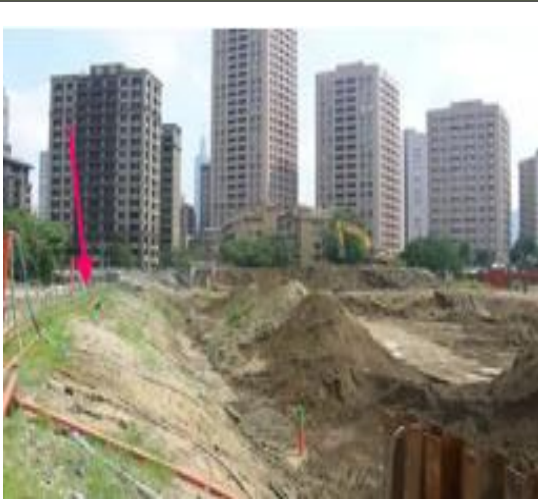
邊坡超過2公尺無防護措施及警語
