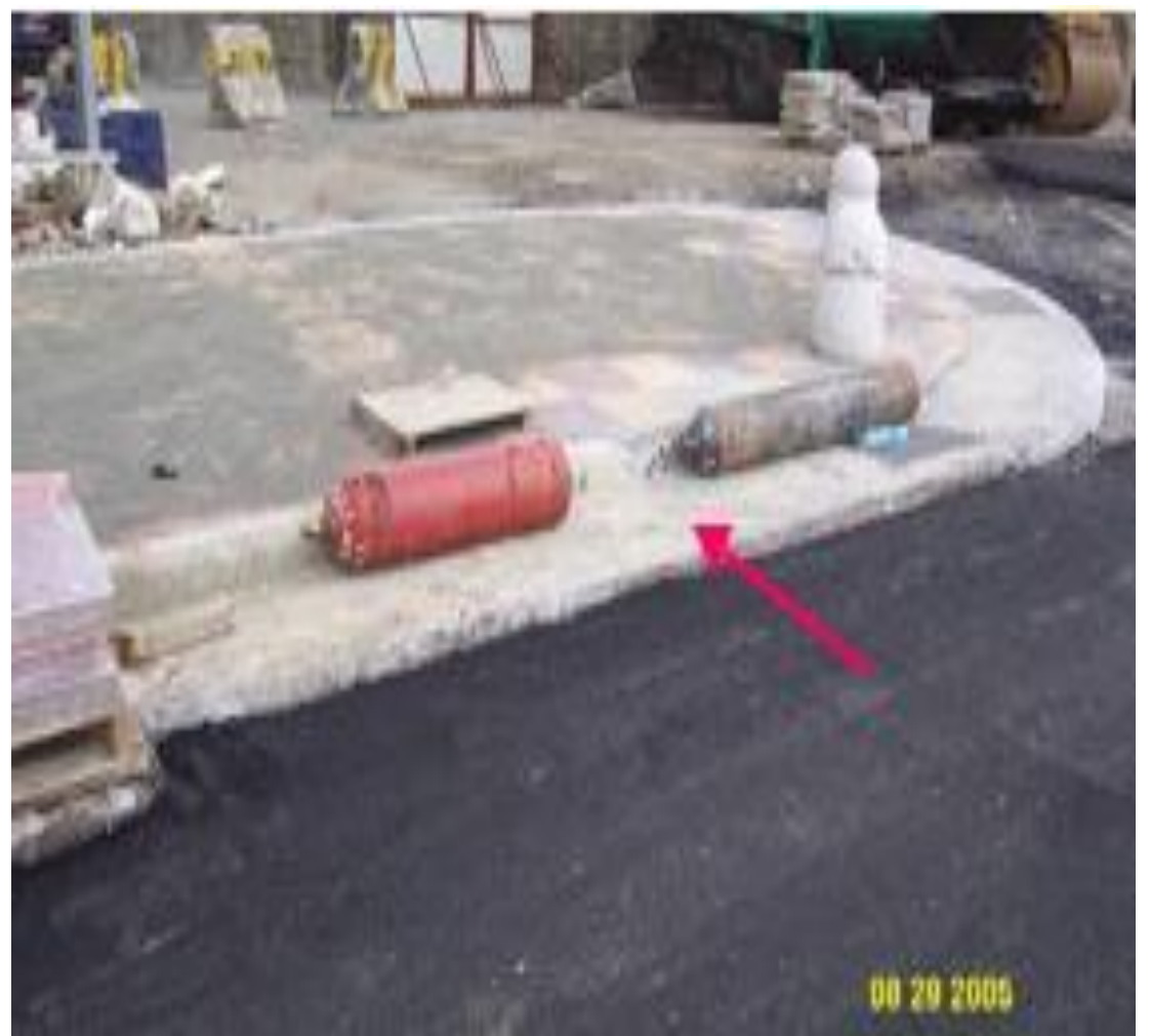
鋼瓶未直立放置
