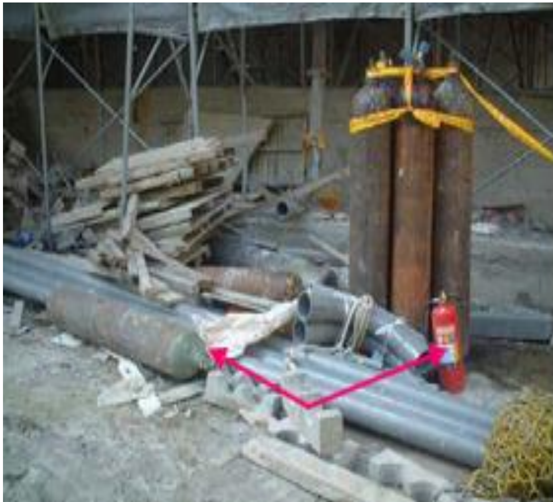
鋼瓶未直立放置
