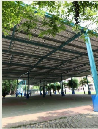
光電運動場 頂蓋直接鋪設光電板 具發電功能
