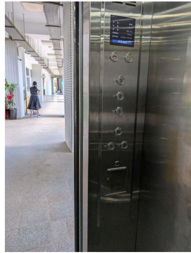
一般操作盤-附點字(視障使用者)
